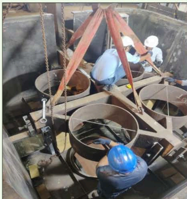
सोडियम सेल की कमीशनिंग गतिविधियां Commissioning activities of sodium cell
